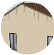
Traces sur un pignon de maison au droit des jonctions de tuile de rive
